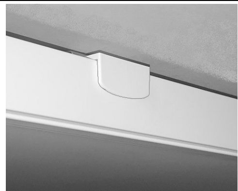
Figure 5. Pince correctement installée.
